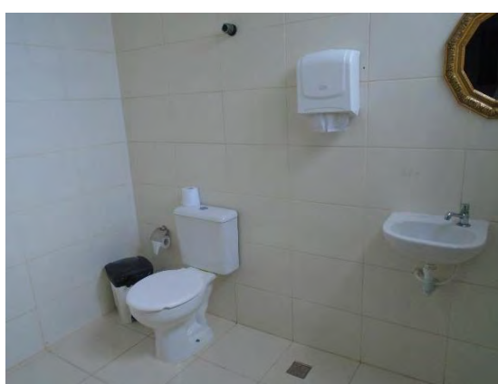
Foto 21 – Coletor nos sanitários com tampa e pedal.
